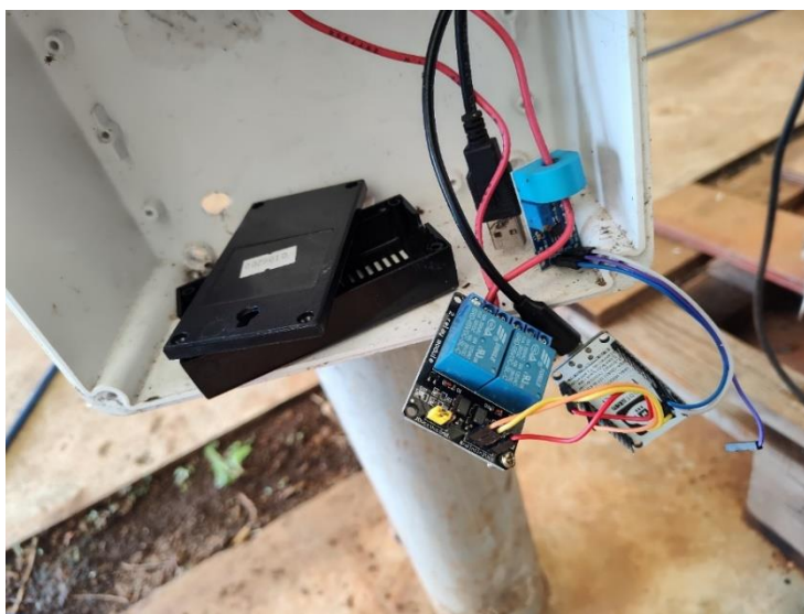
Figura 25: Caja estanco de una columna del Invernadero
