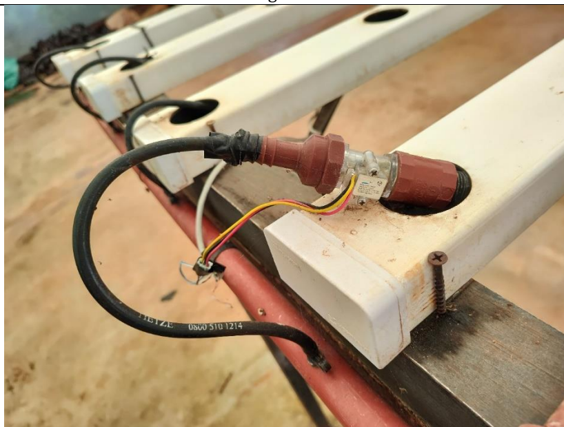
Figura 30: Actuador que vierte agua en canal de Hidroponia
