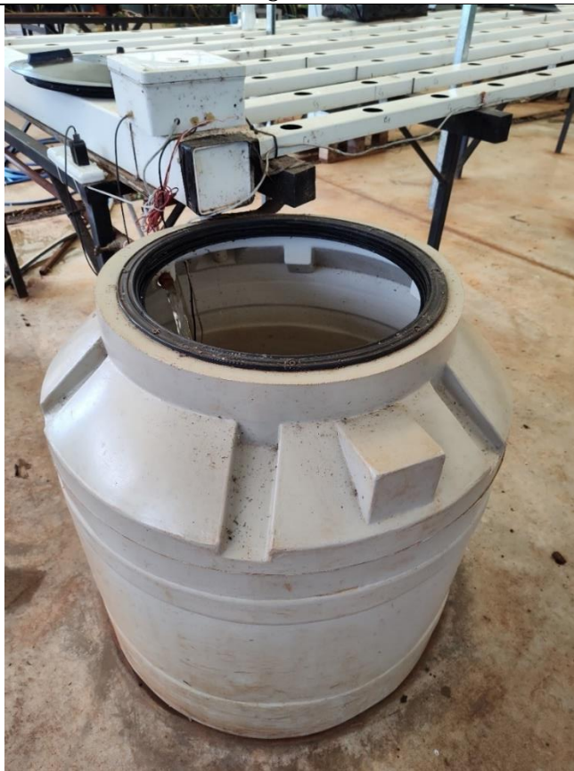
Figura 31: Tanque de agua con su caja estanco
