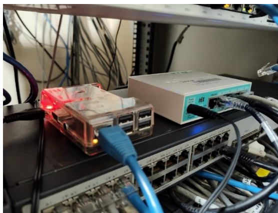
Figura 14: Servidor Raspberry Pi en el Rack del Datacenter de la FCEQyN (vista modular)
